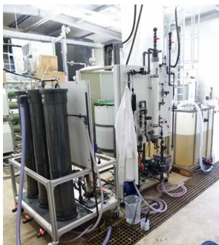
F4P-Versuchsanlage mit Sicht auf diverse Aufbereitungs-module (z. B. Membranmodule – links)
